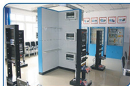
网络综合布线实训室
